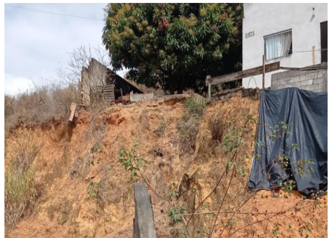
Figura 9 – Área 3: Talude com parte de sua estrutura erodida.
