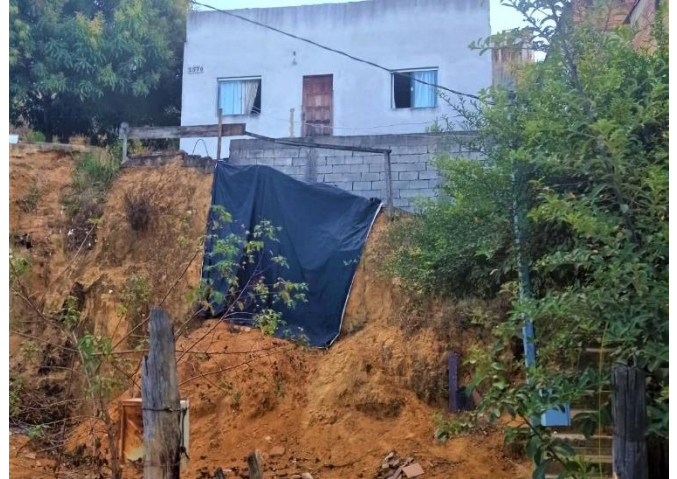
Figura 8 – Área 3: Residência próxima a um talude com indícios de instabilidade.
