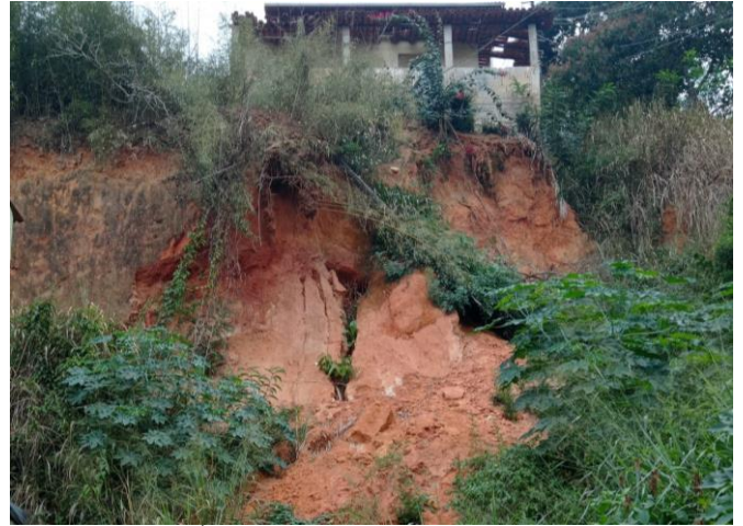
Figura 12 – Área 5: Residência à beira de um talude em estágio de erosão avançado.
