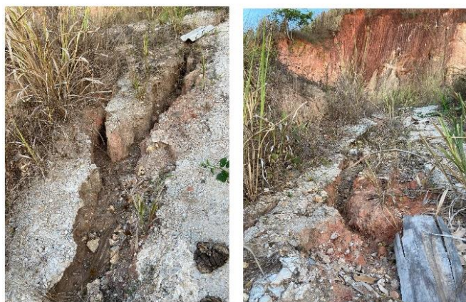
Figura 6 – Ravinas presente no maciço do talude.
