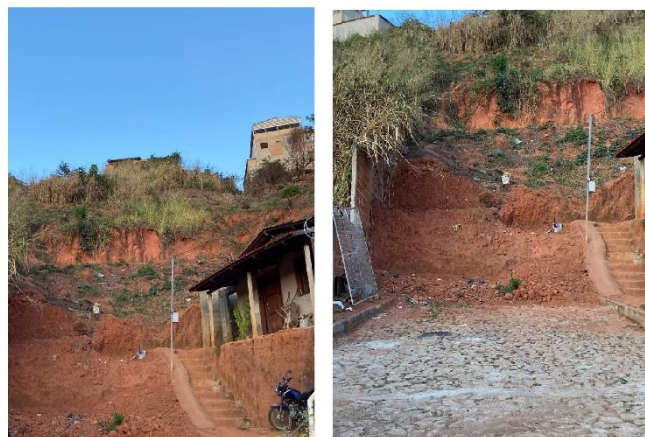
Figura 4 – Talude com interferências Antrópicas.
