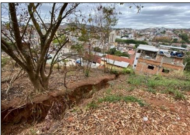
Figura 6 – Edificação 136: vala no topo do talude.
