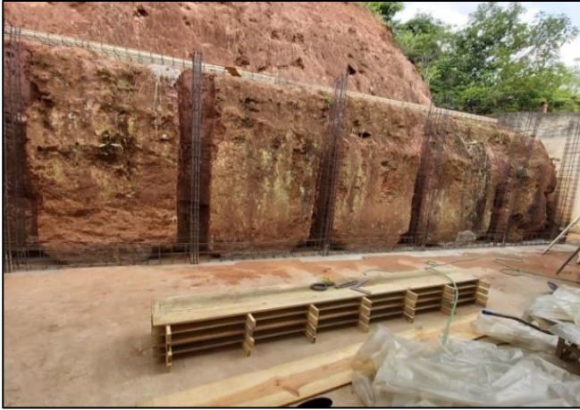
Figura 4 – Edificação 124: contenção após deslizamento.
