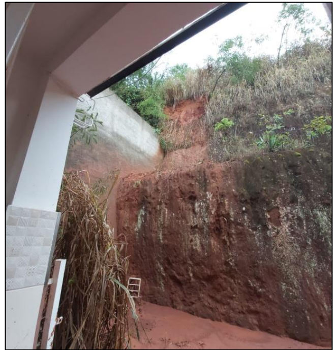
Figura 3 – Edificação 124: deslizamento planar.
