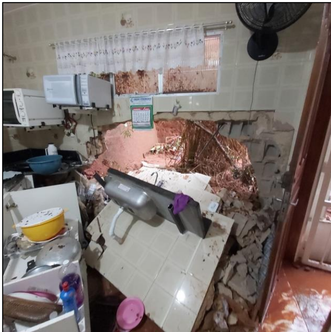
Figura 2 – Edificação 124: térreo atingido.
