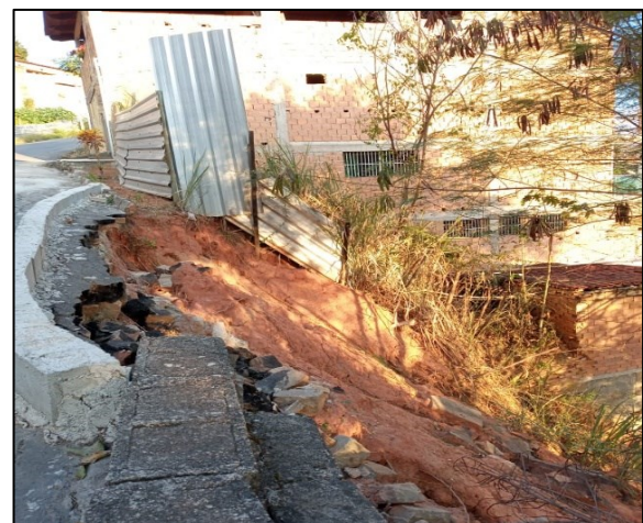
Figura 7 – Blocos de concreto delimitando o entorno da Rua Riccioti Míglío atingida por deslizamento de massa de solo (Ponto 2).
