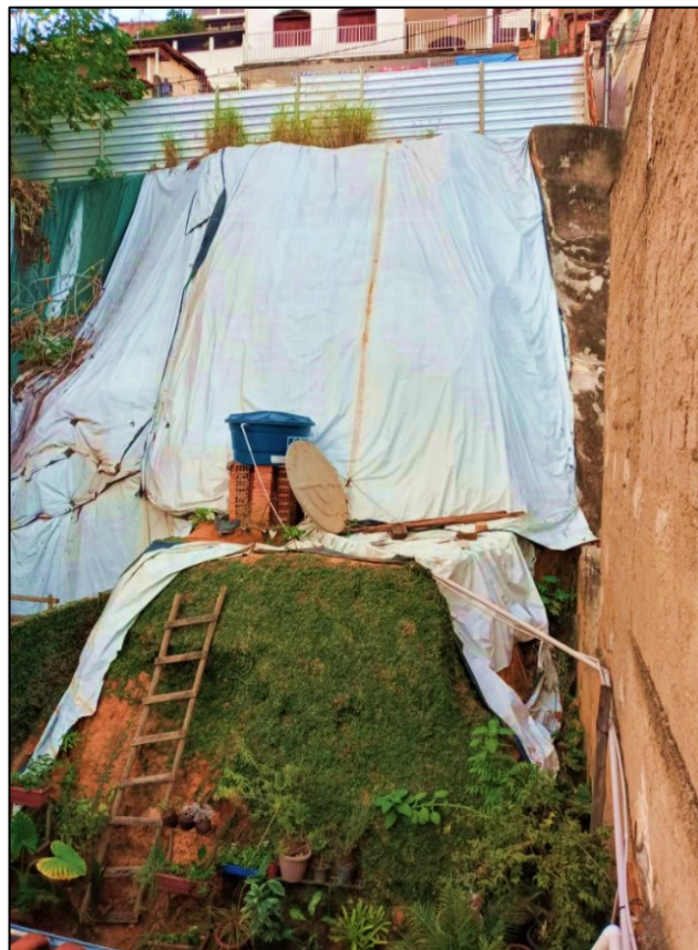
Figura (3) – Talude em corte na Rua Riccioti Miglio (Ponto 1).
