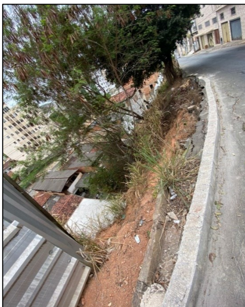
Figura 5 – Vista lateral superior do talude em corte na Rua Riccioti Míglío (Ponto 2).
