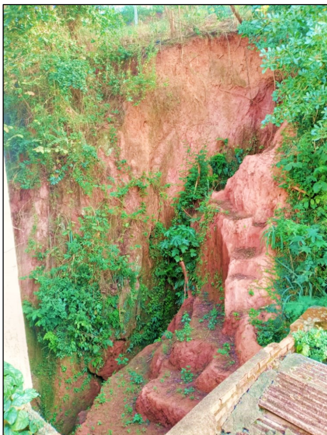
Figura 8 – Deslizamento do talude em corte na Rua Minervino de Castro Pinto (Ponto 3).
