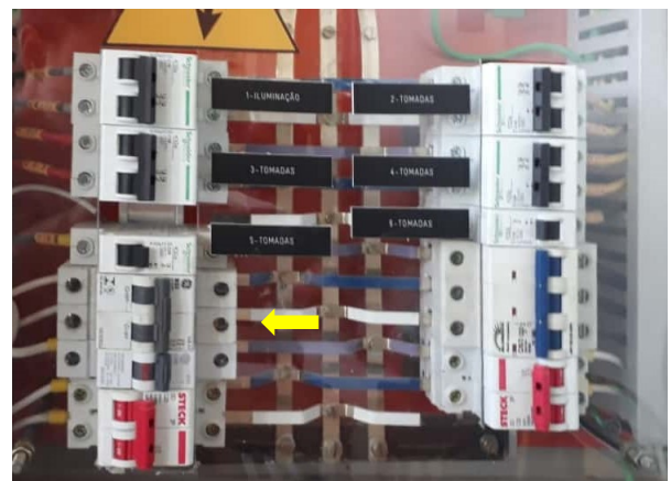
Figura 18 – Disjuntor termomagnético alocado no quadro de distribuição.
