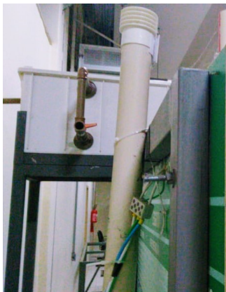
Figura 16 – Tubo ventilador e terminal de ventilação.
