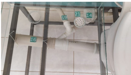
Figura 15 – Instalações de esgoto cloacal.
