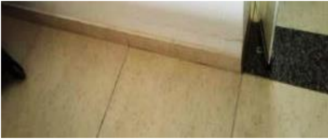
Figura 3 – Fissura na parede entre o banheiro e o quarto, a patologia está “paralela ao piso.
