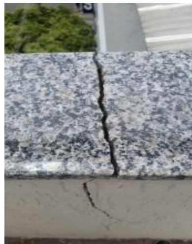
Figura 8 – Trica no guarda corpo do prédio.
