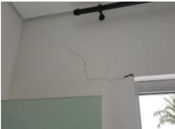
Figura 5 – Fissura em 45 graus situada na mesma região da patologia da varanda, porém é na parede do quarto.
