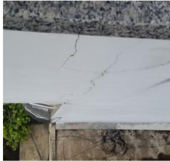
Figura 6 – Fissura externa na cobertura do prédio, acima do apartamento, a patologia está adentrando essa parede de alvenaria.
