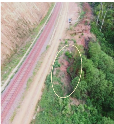
Figura 5 – Ruptura do talude do aterro. Pará, Brasil. 2020.
