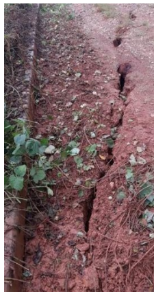
Figura 6 – Trinca na plataforma. Pará, Brasil. 2020.
