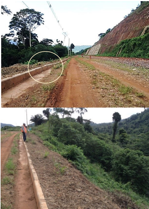
Figura 4 – Plataforma com abatimento de formação de superfície de ruptura em foto à esquerda e talude do aterro excessivamente íngreme à direita. Pará, Brasil. 2020.
