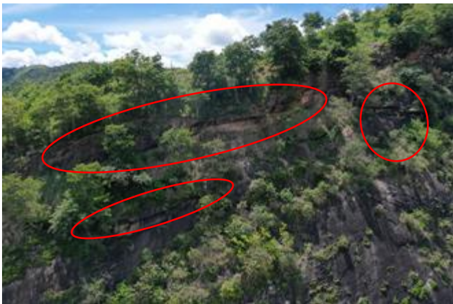
Figura 6 – Ponto 01: Descontinuidades na parte mais alta do paredão com raízes de vegetação presentes entre as fraturas do maciço rochoso do bairro Pedreira.
