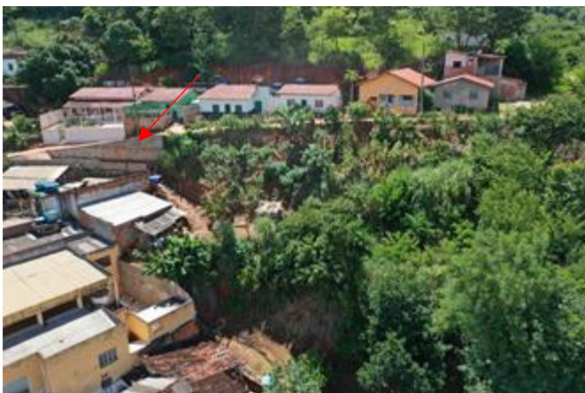
Figura 11 – Ponto 04: Estruturas construídas no bairro e ravinas no solo devido a erosão. Coordenadas geográficas: 41°41'22,9"W e 18°2'2,8"S.
