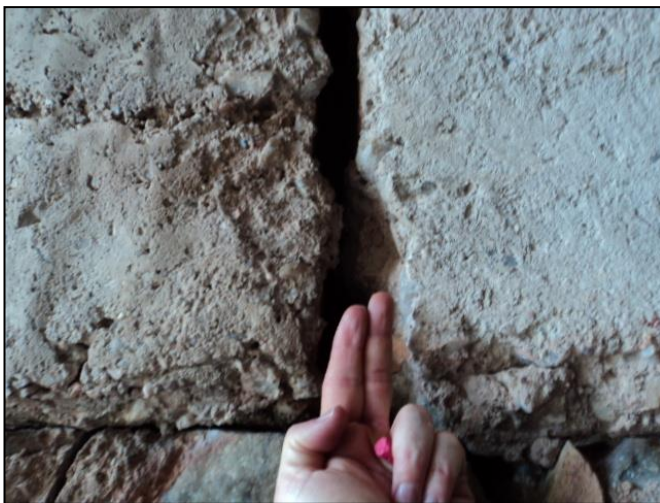
Figura 19 – Trincas em estruturas perto da boca de jusante do bueiro ogival próximo ao distrito de Conselheiro Mata.
