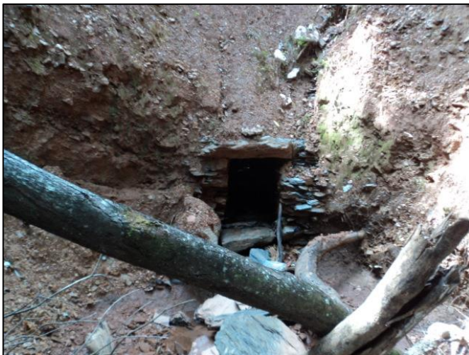
Figura 11 – Processo erosivo desencadeado de jusante para montante de dispositivo de travessia.
