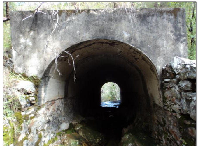
Figura 12 – Boca de entrada (montante) do bueiro ogival próximo ao distrito de Conselheiro Mata.
