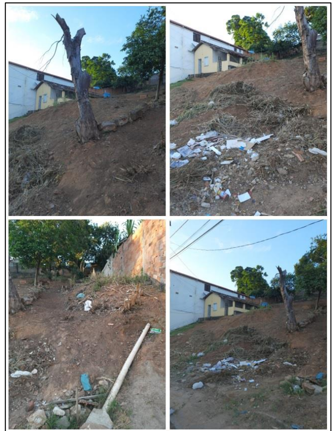
Figura12 – Ponto 06, talude com presença de lixo e tronco inclinado.
