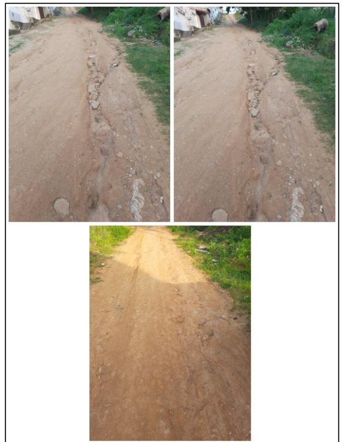
Figura10 – Ponto 05, ravinas em estrada.
