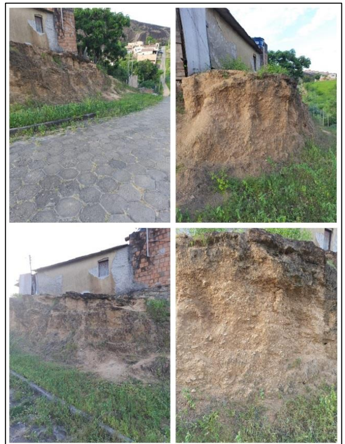
Figura4 – Imóvel localizado em talude com processos erosivos.
