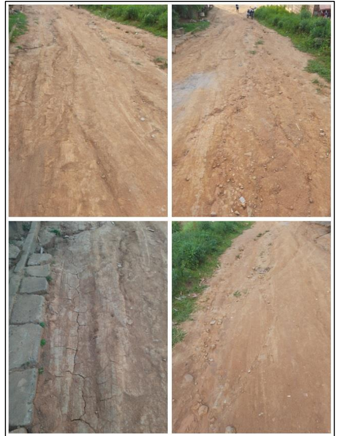
Figura09 – Ponto 04, trincas e ravinas na Estrada.
