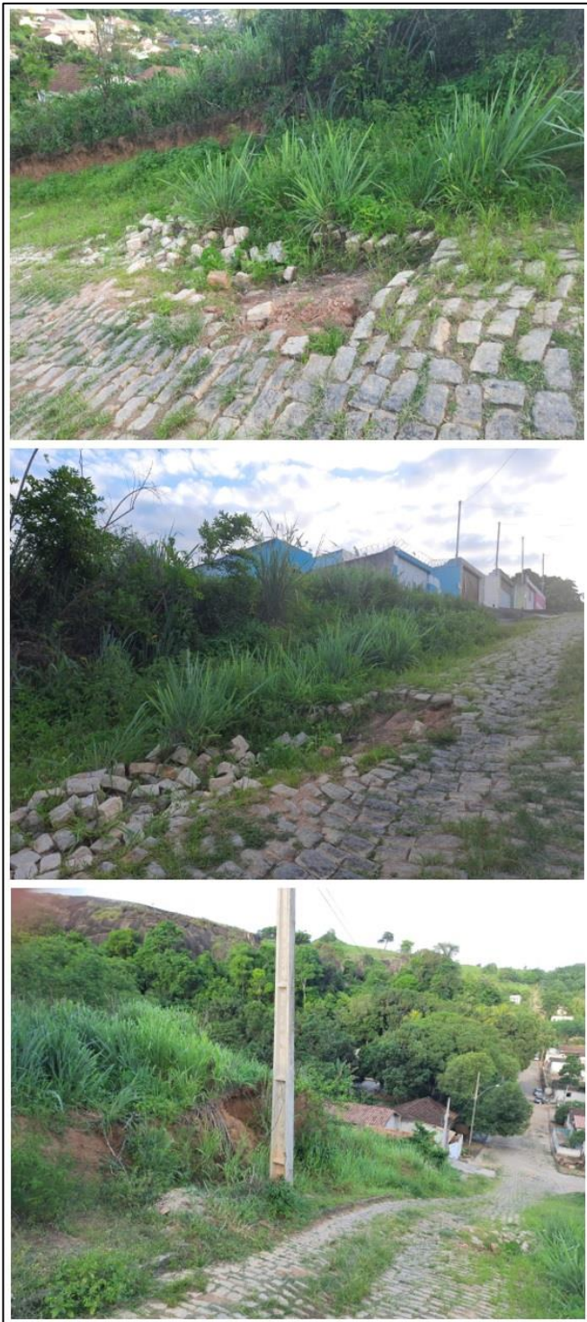
Figura8 – Rua com descolamento de pavimento.
