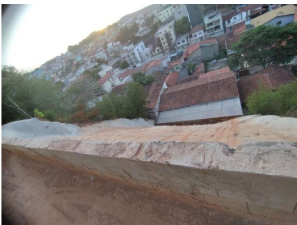
Figura 9 – Ausência de drenagem na Rua Oito.
