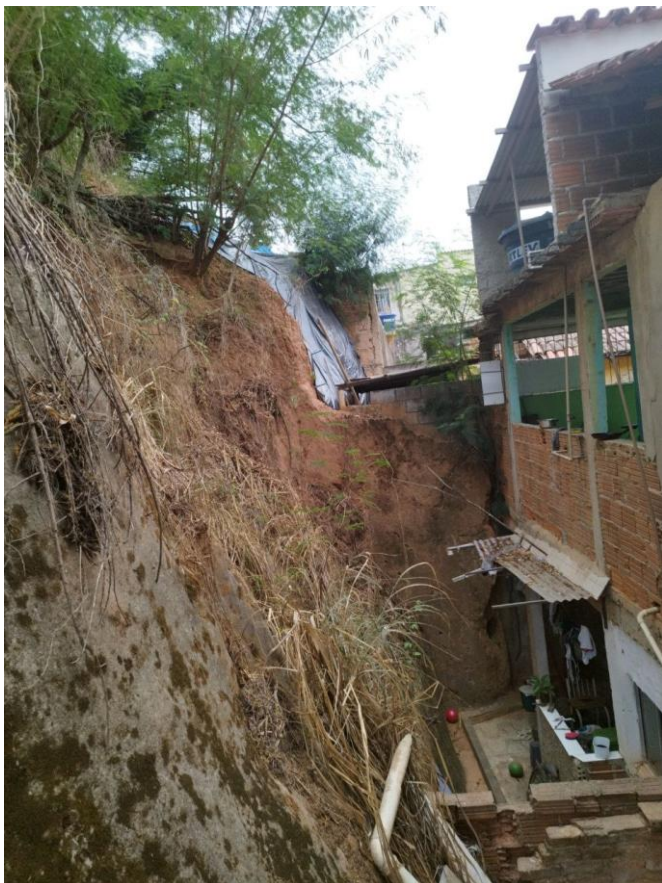
Figura 5 – Talude exposta a erosão vista lateral
