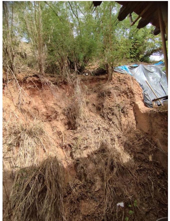
Figura 6 – Talude Exposto a erosão.
