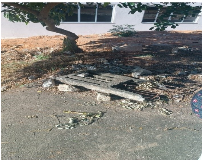
Figura 14 – Boca de lobo quebrada e obstruída.
