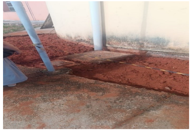
Figura 9 – Local onde estava desconectada a tubulação.
