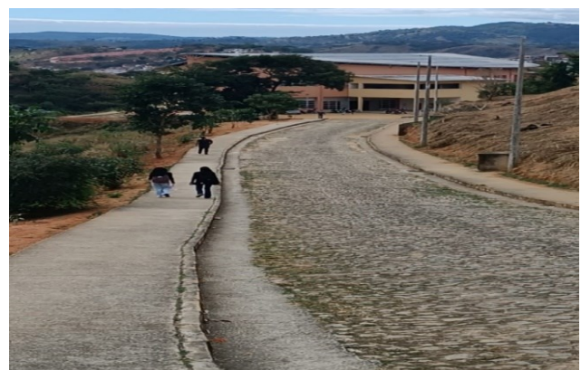
Figura 4 – Localização do ponto mais baixo do sistema de drenagem, o Restaurante Universitário.
