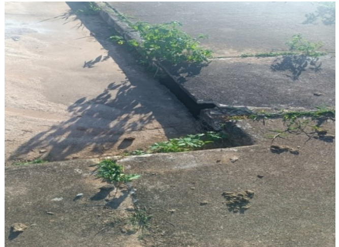
Figura 27 – Acúmulo de areia na boca de lobo.
