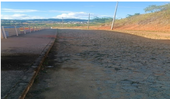
Figura 6 – Ausência de boca de lobo.
