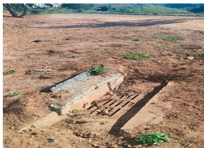
Figura 18 – Obstrução da boca de lobo.
