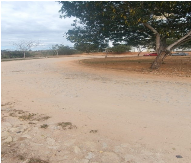
Figura 13 – Insuficiência de boca de lobo.
