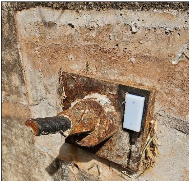
Figura 8 – Tirante com início de corrosão.
