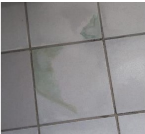
Figura 4 – Manchas de vazamento no piso.
