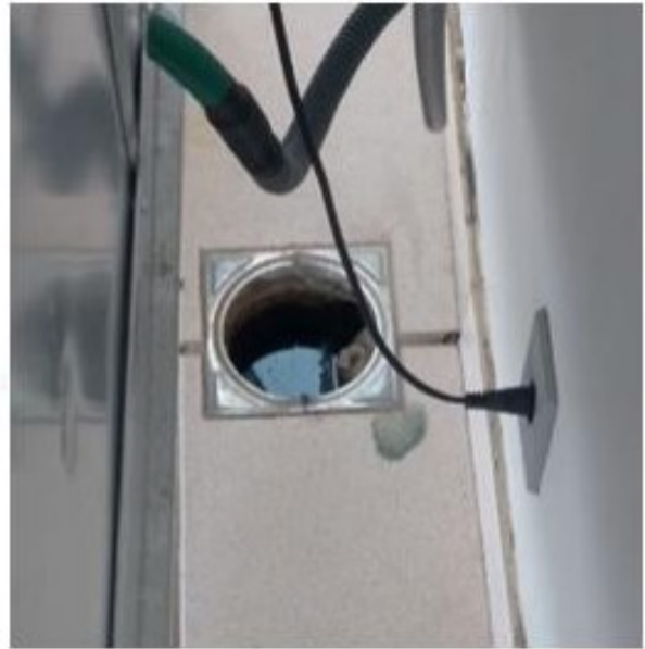
Figura 5 – Ralo do bebedouro sem grelha.
