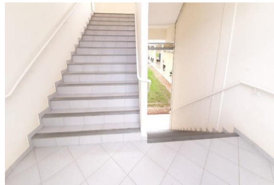
b) Corrimãos tubulares contínuos, sem arestas vista
