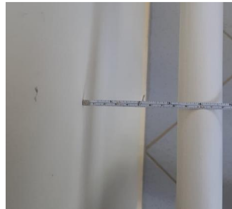
a) Distância de 35mm do corrimão e alvenaria
